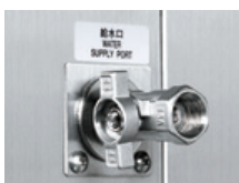
純水供給口(減圧弁付)
